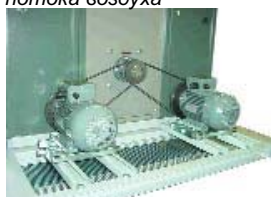
Рабочий и резервный электродвигатель вне потока воздуха
