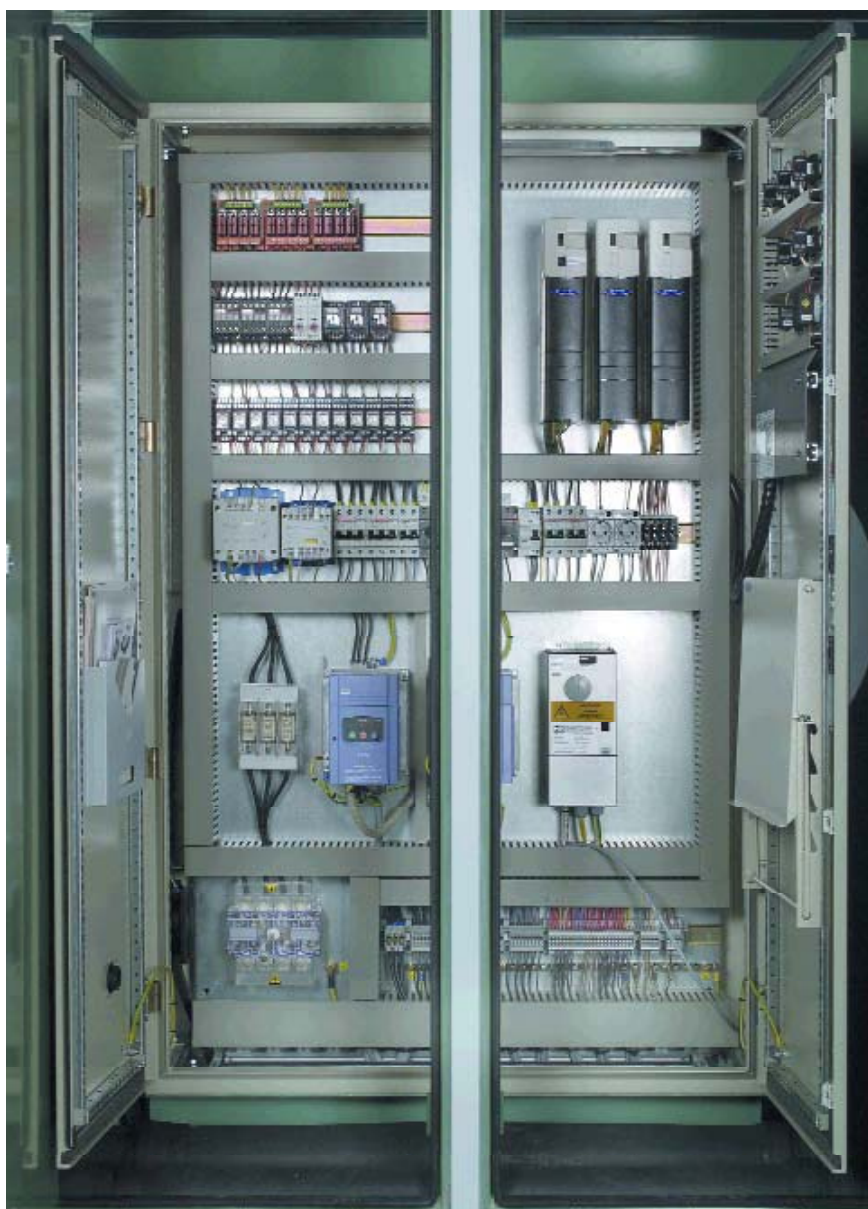
Интегрированный шкаф управления
