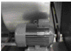
Электродвигатели внутри потока воздуха
